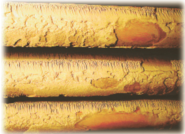
Verflüssigte Asche bildet auf den Wärmetauscherflächen einen festen Belag, der die Flächen in einem rasant ablaufenden Prozess zusetzt und daher unbedingt von Zeit zu Zeit beseitigt werden muss.
