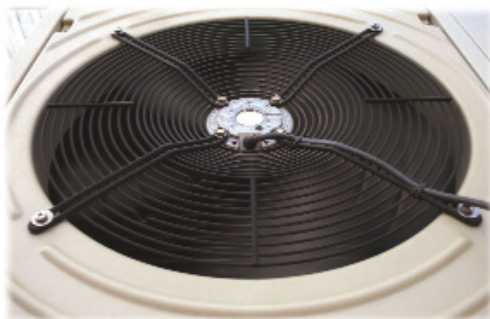
Ohne fachkundige Wartung vermehren sich im angesammelten Staub der Klimaanlage Keime, Pilze und Krankheitserreger. Wie durch die Röhren einer U-Bahn können sie jeden Raum im Gebäude erreichen. Bilder: S.I.S. - Gruppe
